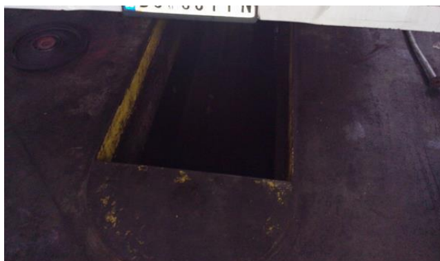
Slika 1: Nebezbedno radno mesto u kanalu za održavanje vozila
